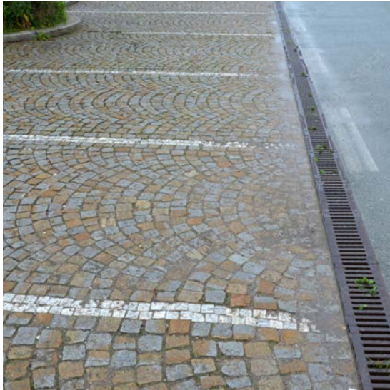
Abb. 3A: Regen – Parkplatz – Kanalisation
